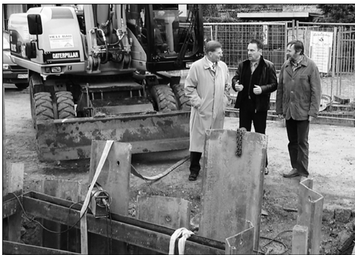
Verbandsvorsitzender Herr Creter, Bürgermeister Herr Heiland und Herr Friedenberger von der Köstritzer Schwarzbierbrauerei GmbH (v. l.) bei der Baustellenbesichtigung
