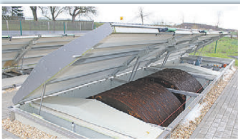
Teil des Reinigungsprozesses: An Scheibentauchkörpern haften Bakterien und werden regelmäßig mit Sauerstoff versorgt. Danach erfolgt die Phosphatentfernung mittels Eisen- oder Aluminiumsalzen.
