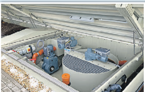
Der Misch- und Flockungsreaktor: Hier wird durch Zugabe von Eisen- oder Aluminiumsalzen Phosphat aus dem Abwasser entfernt.
