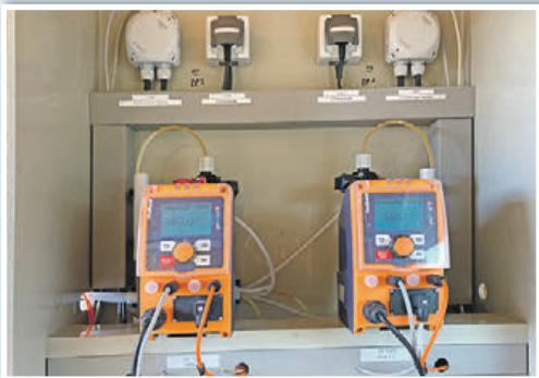
Modernste Technik für den Rund-um-die-Uhr-Betrieb. 11 m³ Abwasser werden pro Tag verarbeitet. Genauestens geprüft wird die Einhaltung von Grenzwerten.
